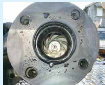
異物を除去した後のポンプ内部
