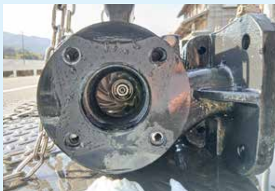
異物を除去した後のポンプ内部
