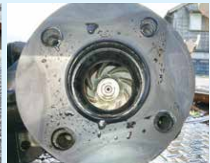
異物を除去した後のポンプ内部
