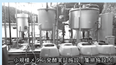
農業集落排水施設 高樋地区
