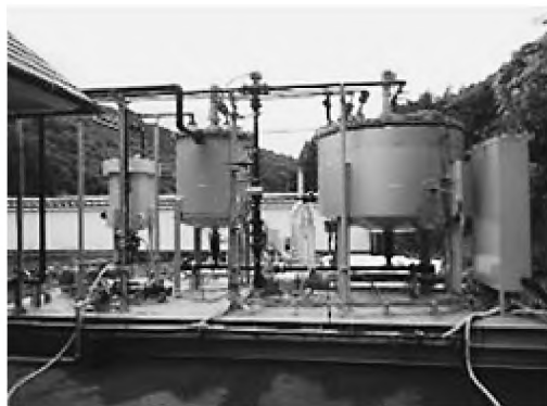
小規模メタン発酵実証施設 (集排施設内)
